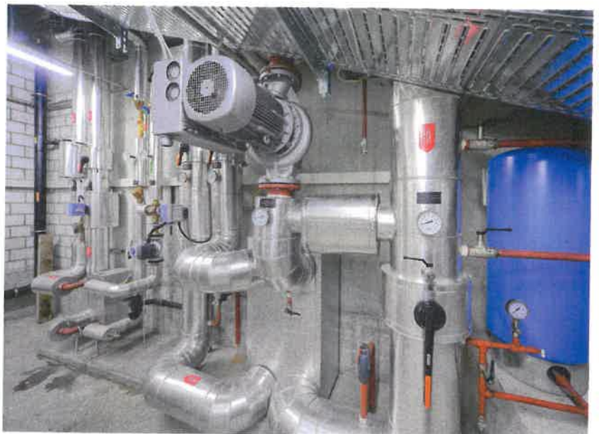
Heizgruppenaufbau Rasenheizung Sportanlage Letzigrund. (Foto: energo)
