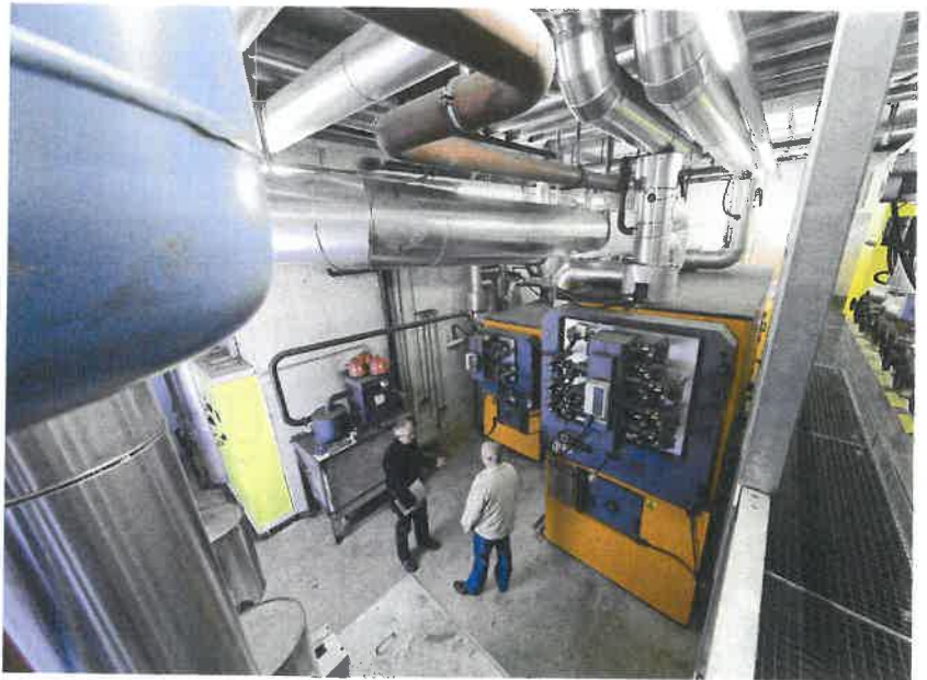
Heizzentrale Sportanlage Letzigrund. (Foto: energo)
